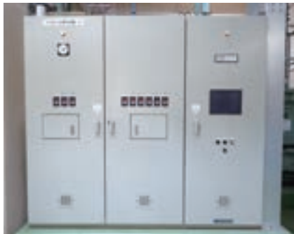
汚泥脱水設備制御盤
