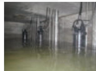
ポンプピット 内
