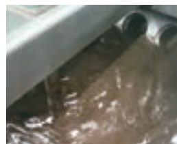
汚泥凝縮湿和状況 (脱水機本体へ)
