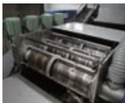
汚泥脱水状況
