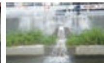
試運転状況(吐出し状況)
