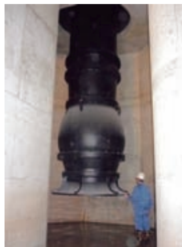
吸込み槽（下部）
